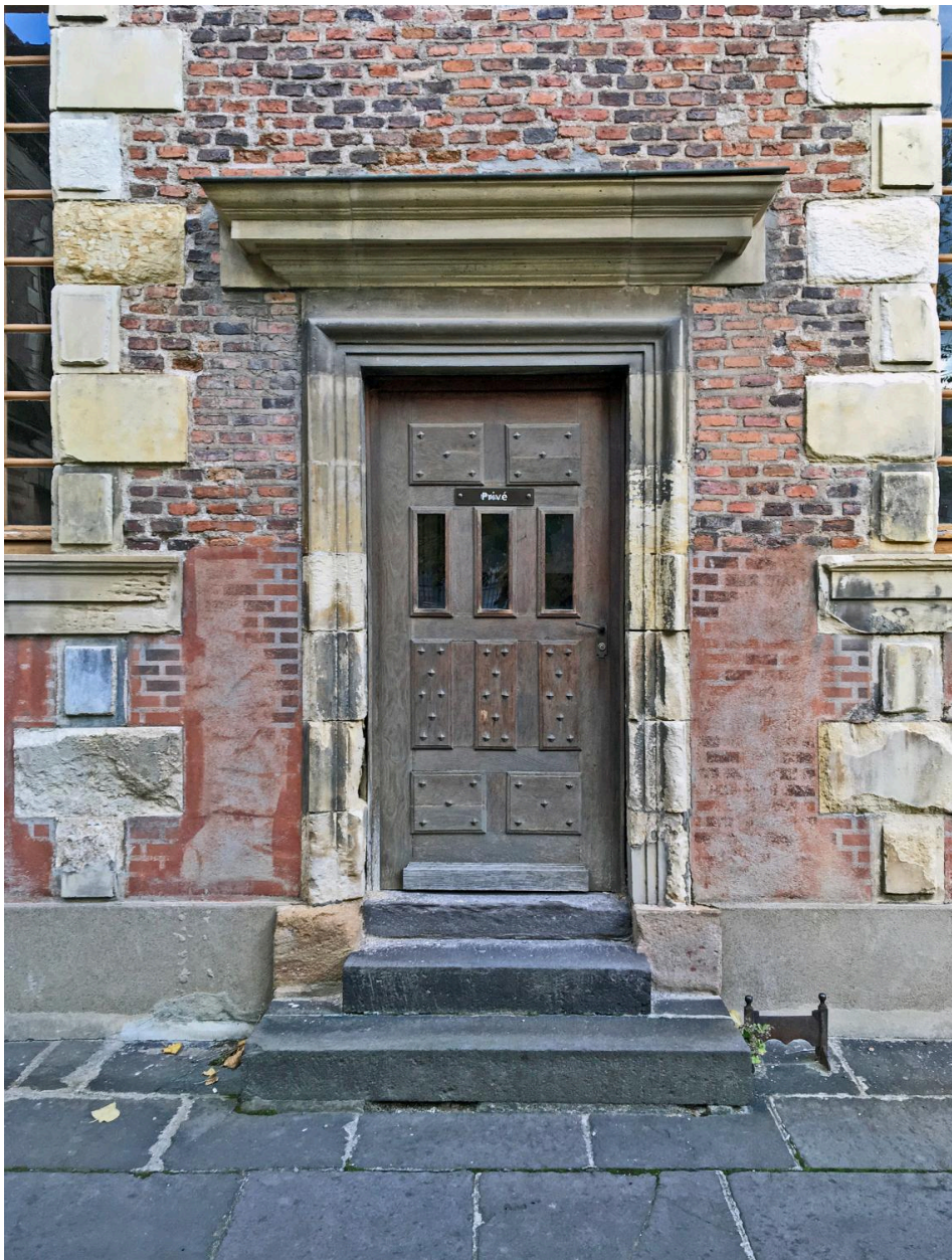
Corps de bâtiment principal, ancienne porte de classe (avec réfection partielle de l'encadrement et de la corniche)
