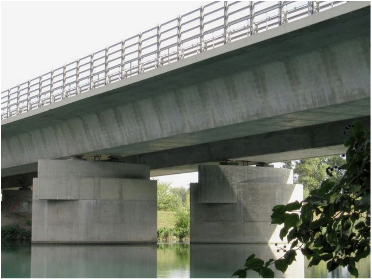
Vue des piles et du tablier, partie du pont sur le canal de Jonage, face aval (depuis la rive gauche)
