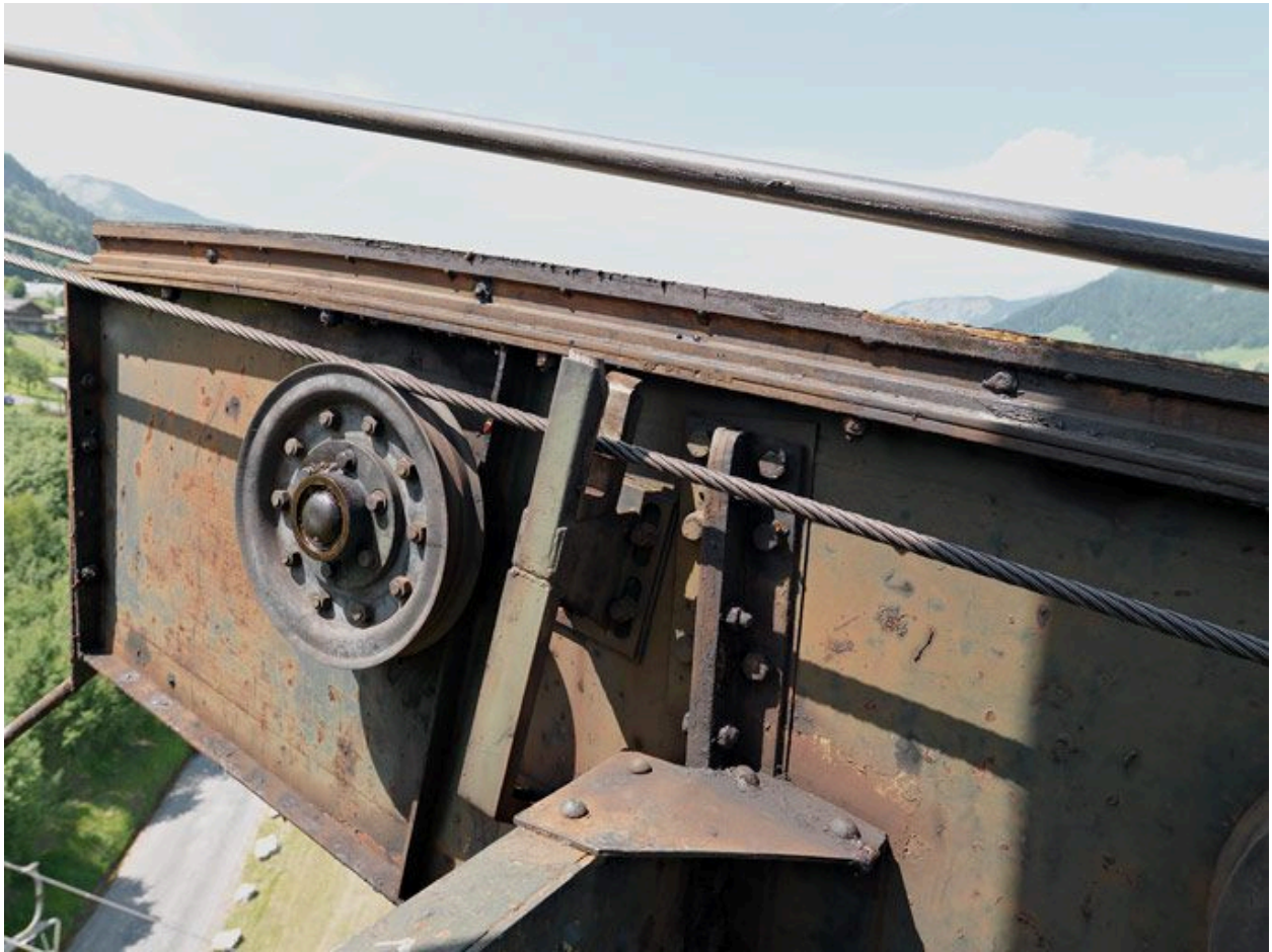
Détail d'une poulie d'entraînement du câble
