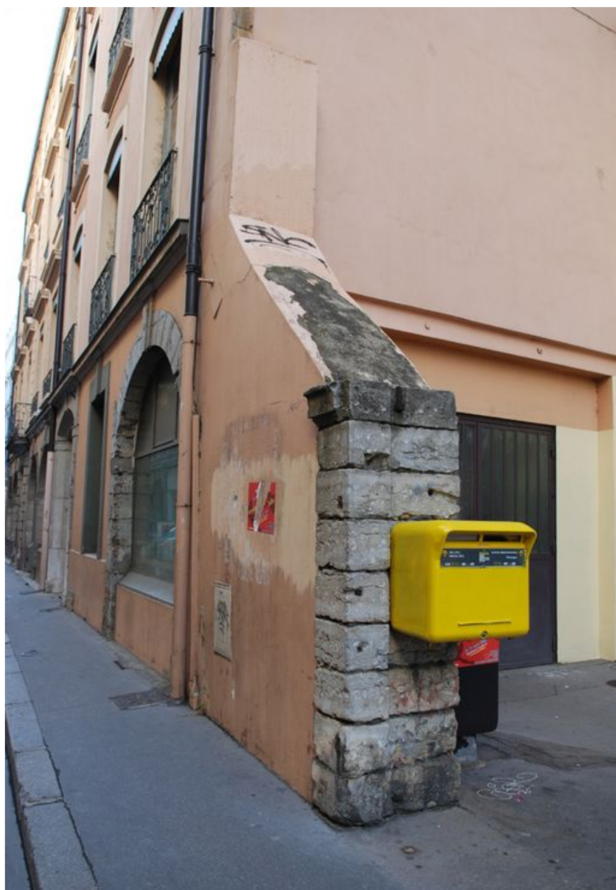
Elévation latérale : arrachement
