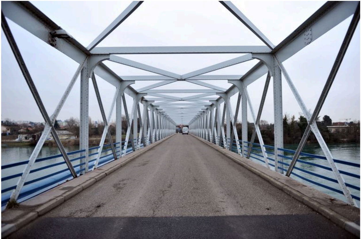
Vue partielle, de dessus, chaussée et structure métallique (depuis la rive droite)
