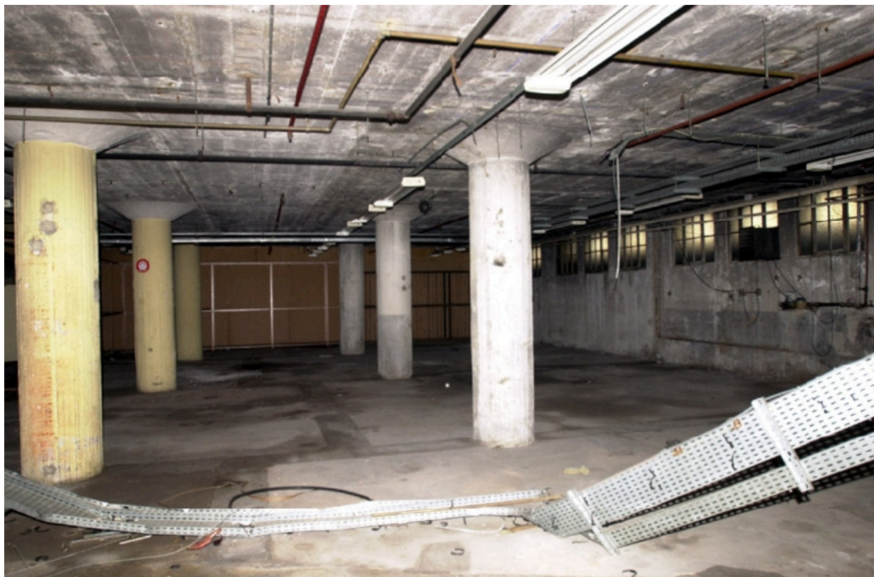
Atelier en sous-sol
