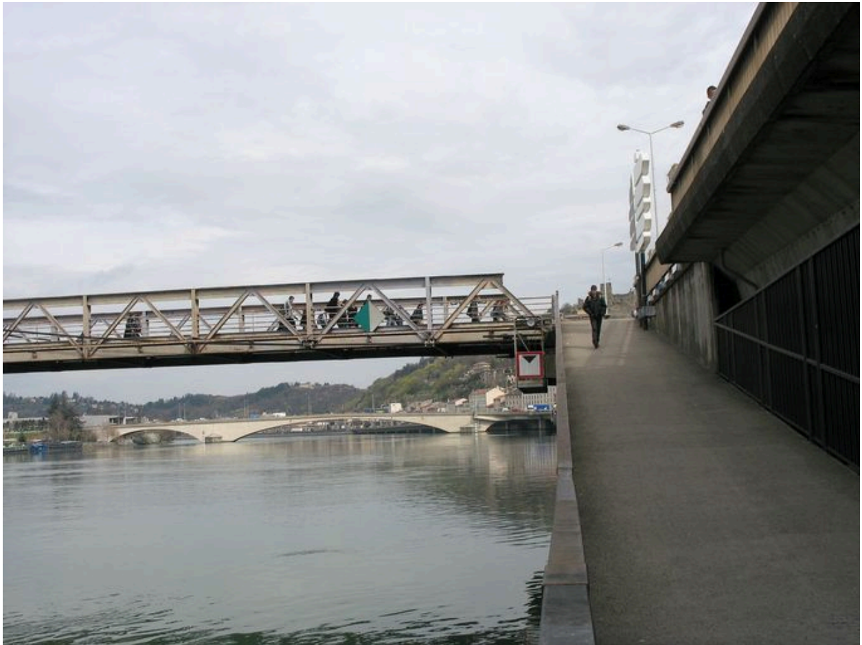
Travée gauche, face aval, vue partielle : accès latéral au quai (depuis la rive gauche)
