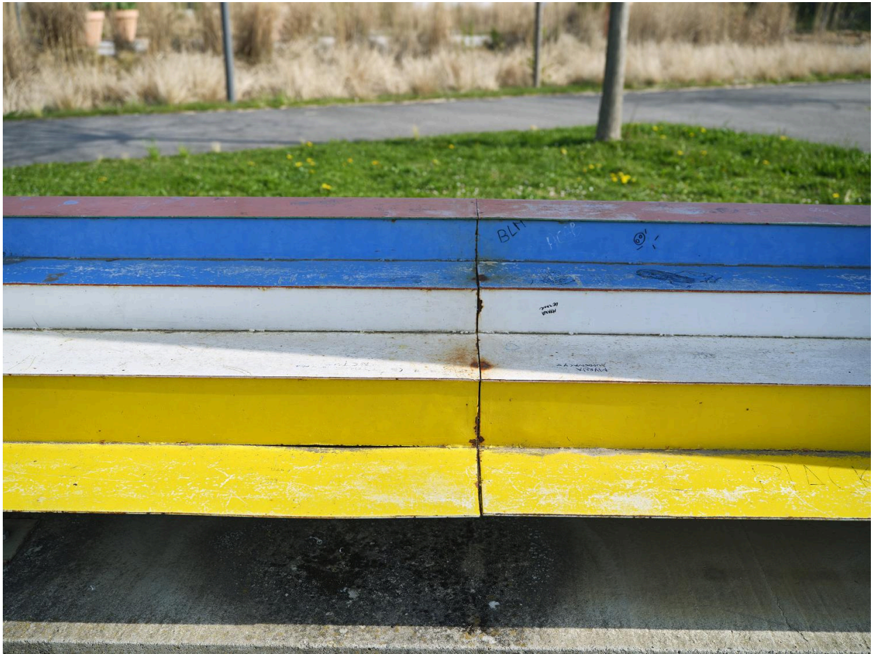
Détail des altérations au point de soudure, partie inférieure
