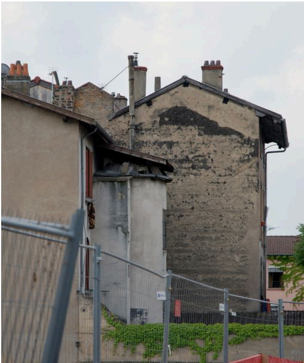
Elévation latérale et postérieure, détail sur la tourelle de la cage d'escalier.
