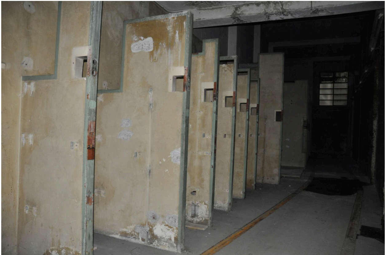
Salle des transformateurs
