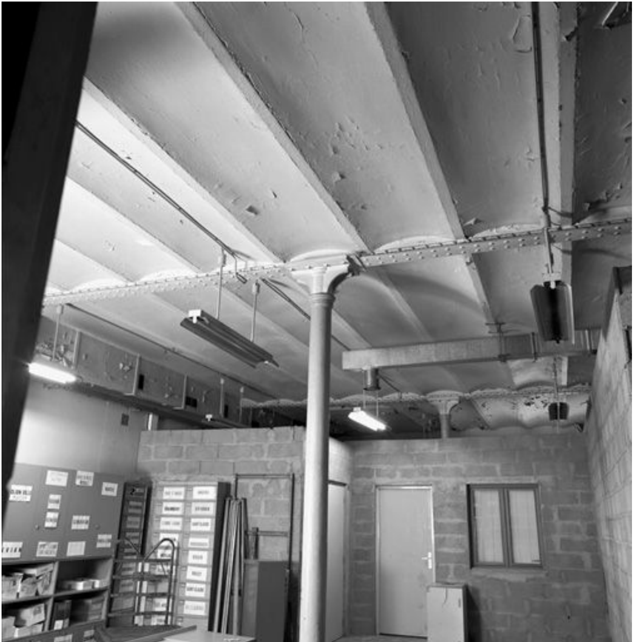
Le bâtiment-voyageurs : souterrain côté Rhône accessible depuis la porte 30 du quai n°1, détail des voûtains et d'une colonne (Micheville 1885)
