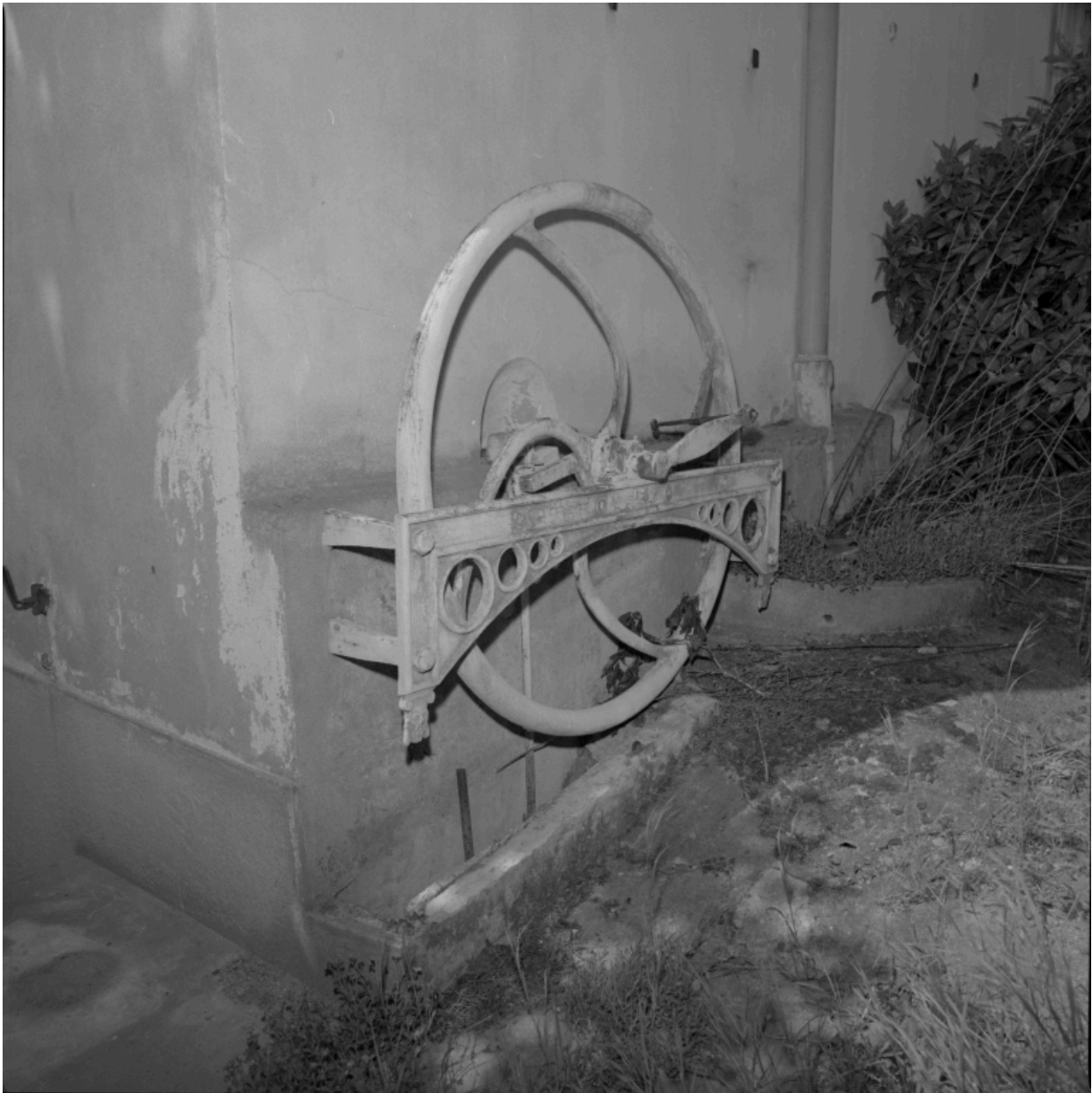
Maison de notable (type VII), dite Les Yuccas, 10 boulevard de l'Industrie (détruite après inventaire) : roue de la pompe à eau.
