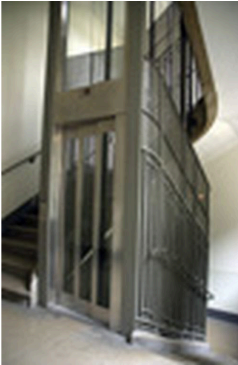
Ascenseur du 12 rue du Port-du-Temple
