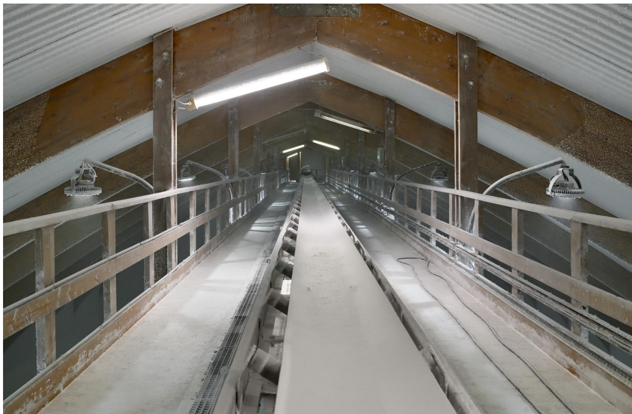
Bande transporteuse d'amenée du sucre au silo (placée en haut du silo)
