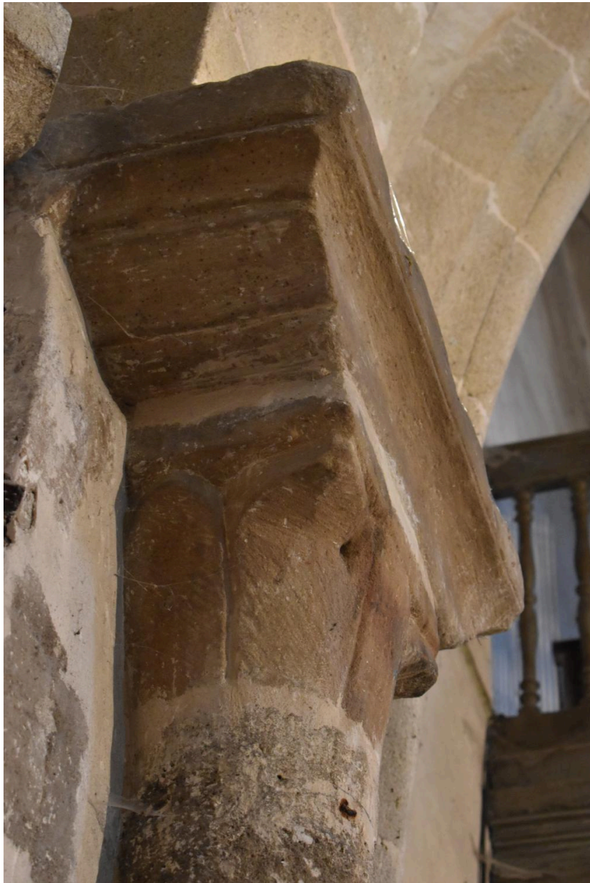
Chapiteau roman sculpté de feuilles d'eau à la retombée sud de l'arc doubleau brisé limitant la première travée et la seconde travée de la nef, vu de trois quarts.
