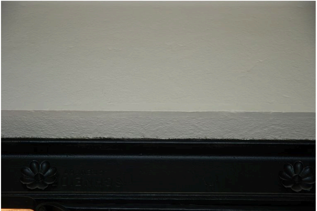
Détail de la marque présente sur une poutre métallique : Schneider, Le Creusot.
