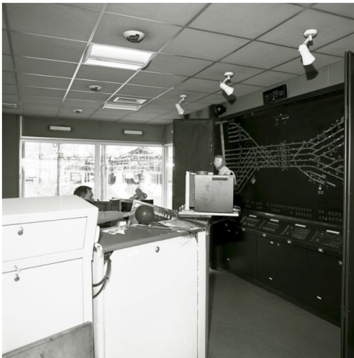
Vue de la salle de commande
