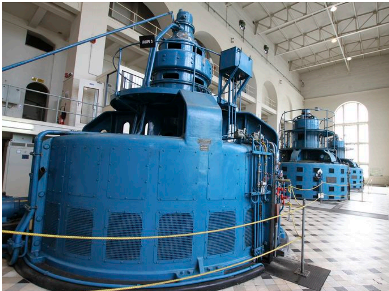
Salle des machines
