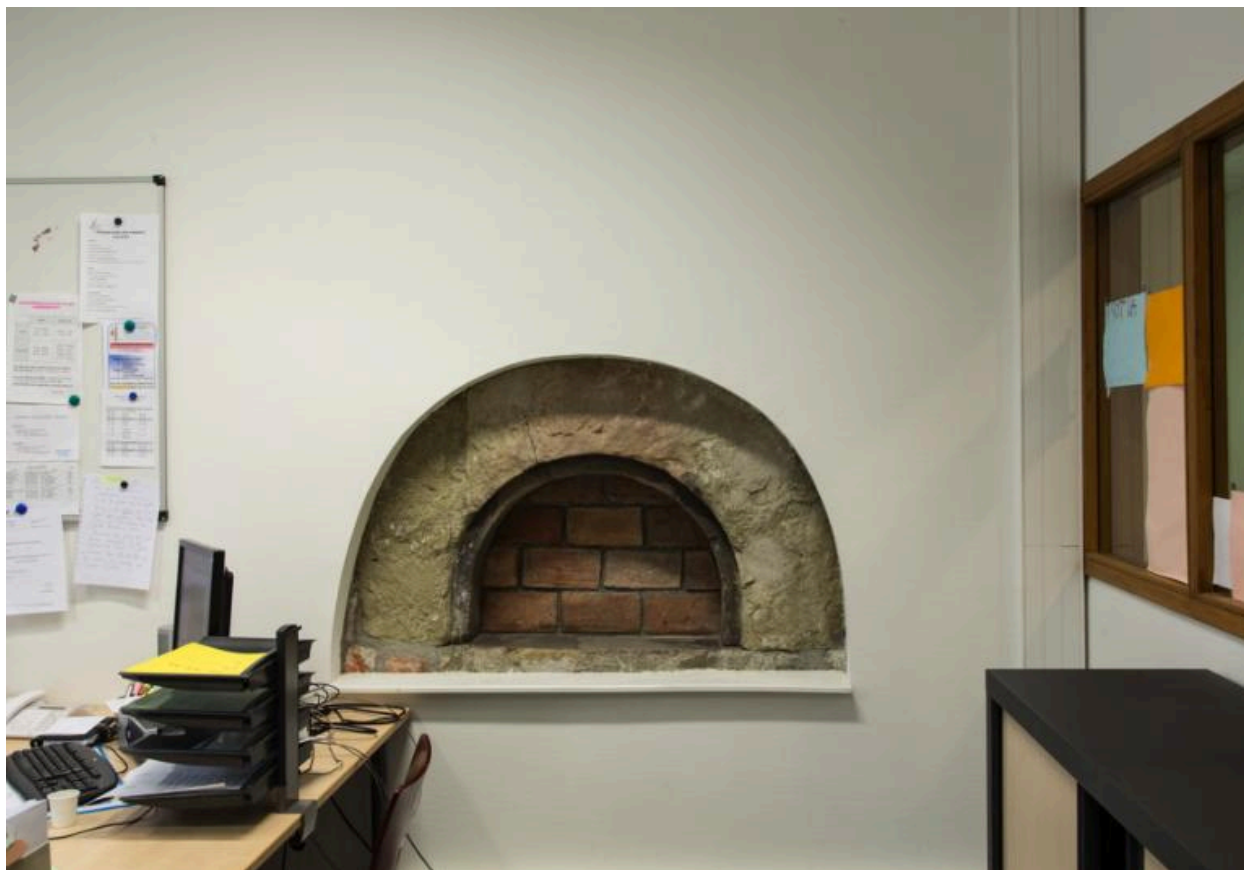
Bâtiment en H, rez-de-chaussée (vie scolaire). Bouche de four dans l'ancienne cuisine.
