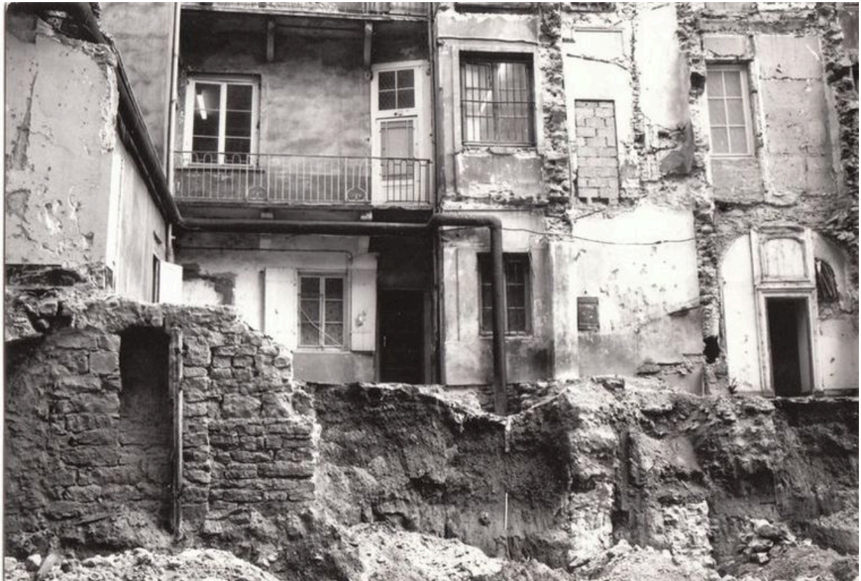
Elévation postérieure lors des travaux du bâtiment ISARA (2nd phase), photographie ancienne, 1972
