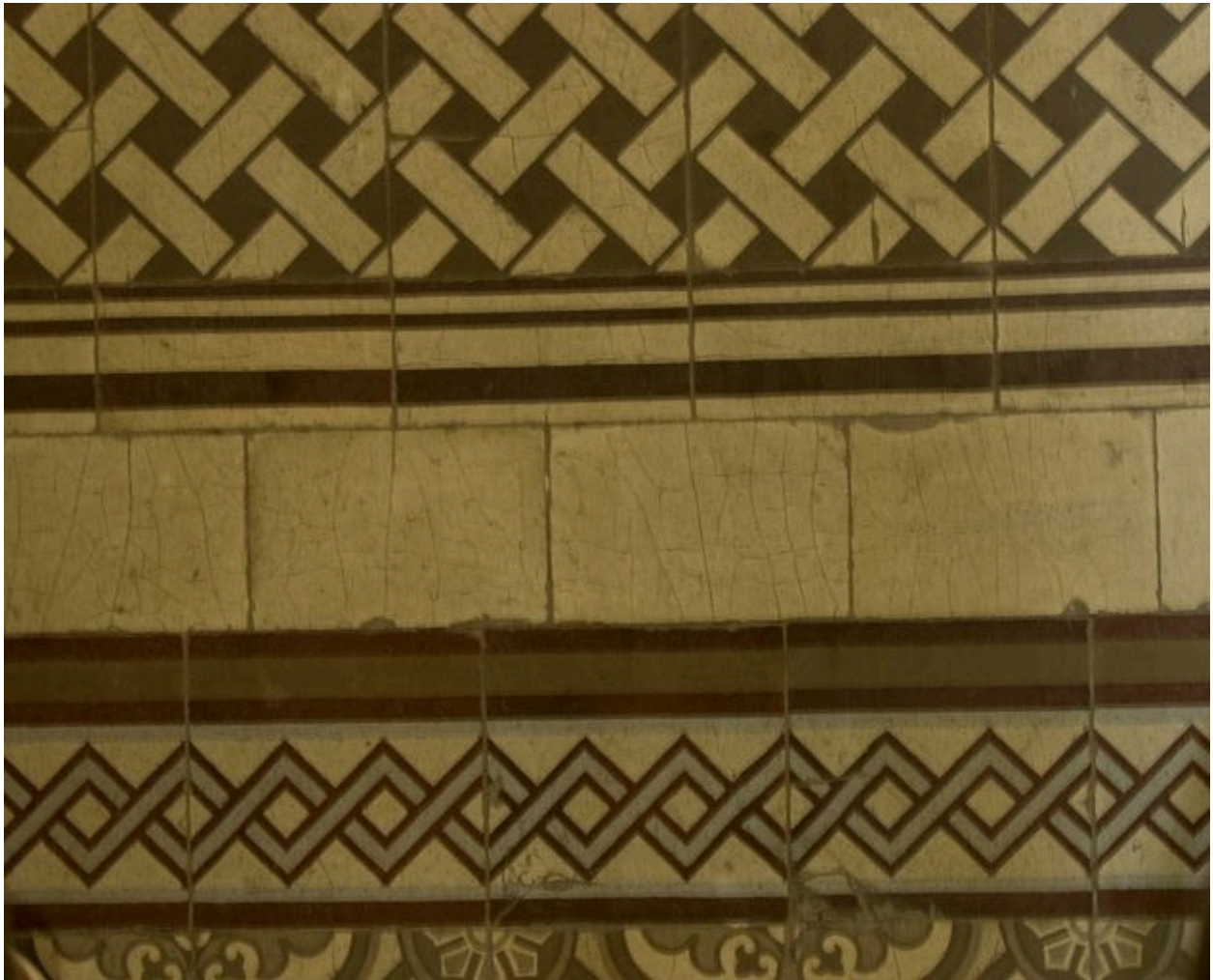
Carrelage du vestibule. Détail de la bande formant transition entre le vestibule et la cage d'escalier
