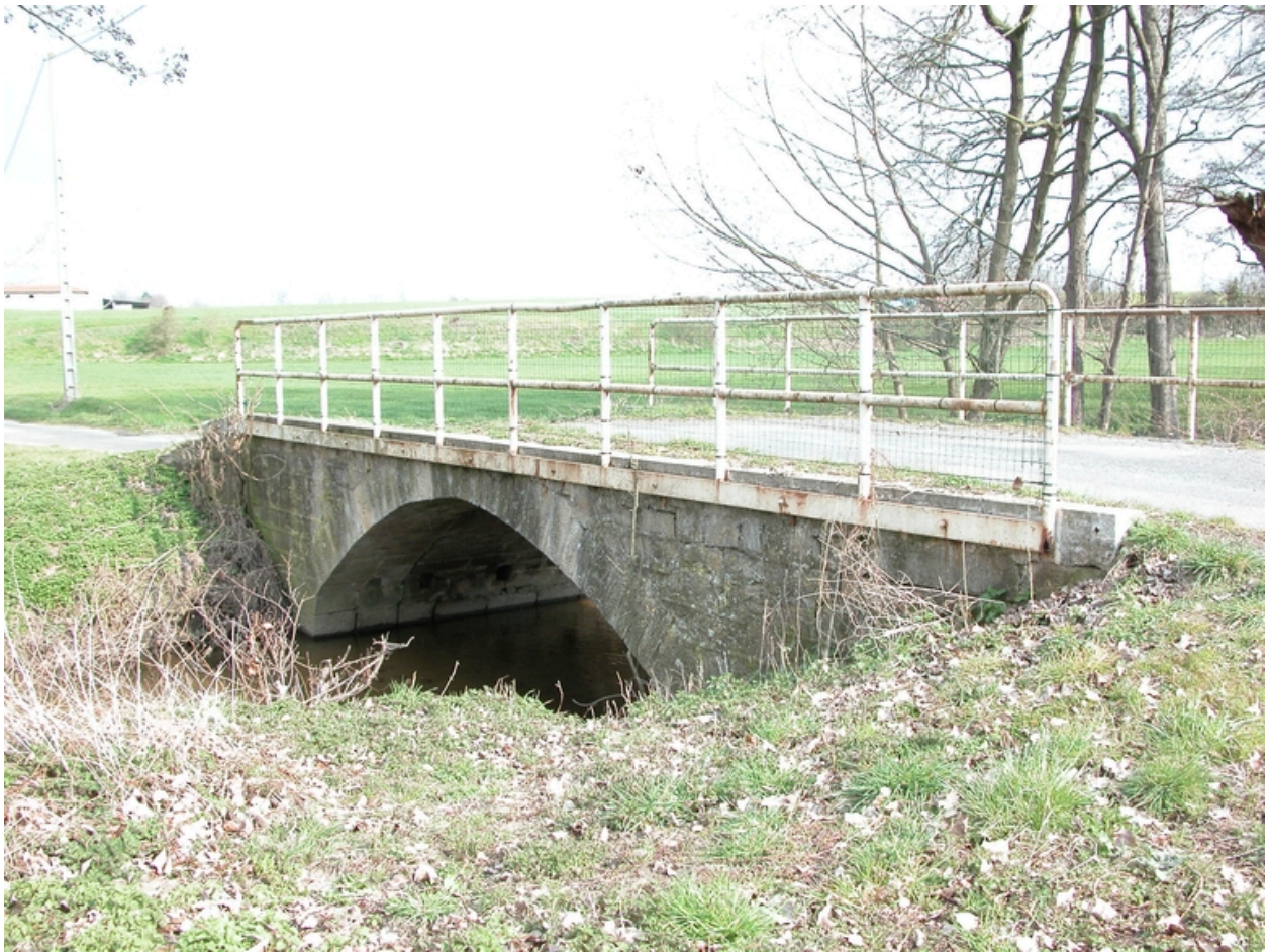
Vue du pont sur le Moingt à Crémérieux (1997 AS non cadastré, vers AS 40).
