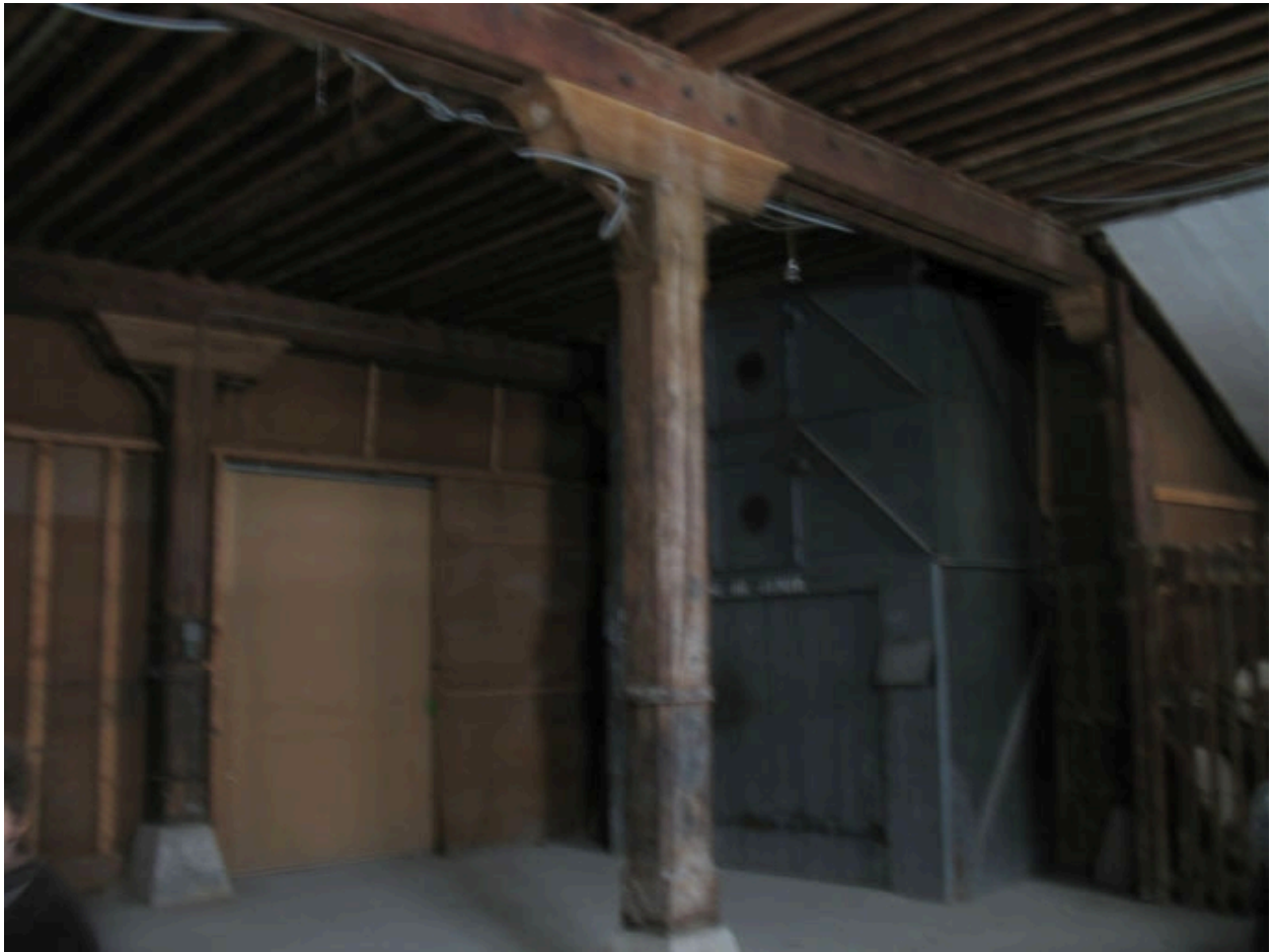
Monte-charge au rez-de-chaussée aile nord angle bâtiment ouest
