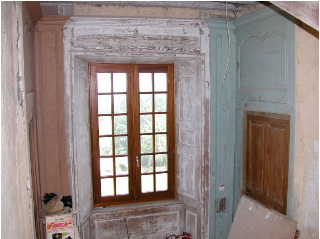
Aile nord de la maison forte, cage d'escalier centrale : vue d'ensemble de la fenêtre et des boiseries l'encadrant.
