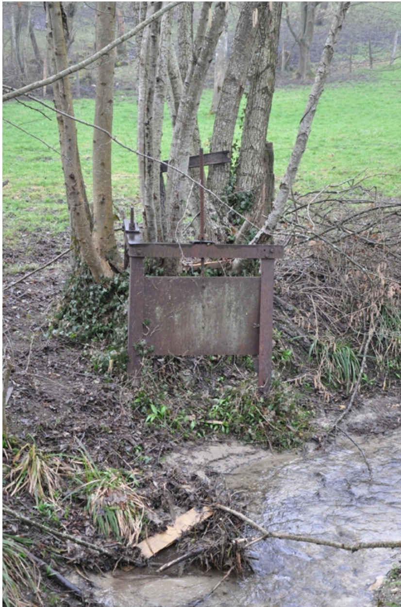
Détails d'éléments de vannage
