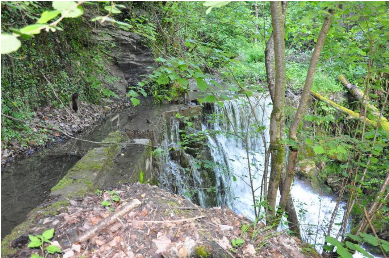
Vue de la prise d'eau.
