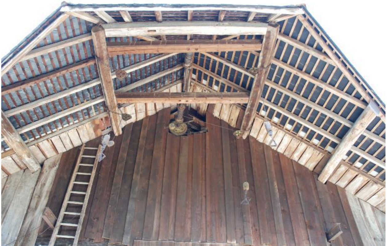
Détail de la charpente et du mur pignon du côté amont (treuil à foin).
