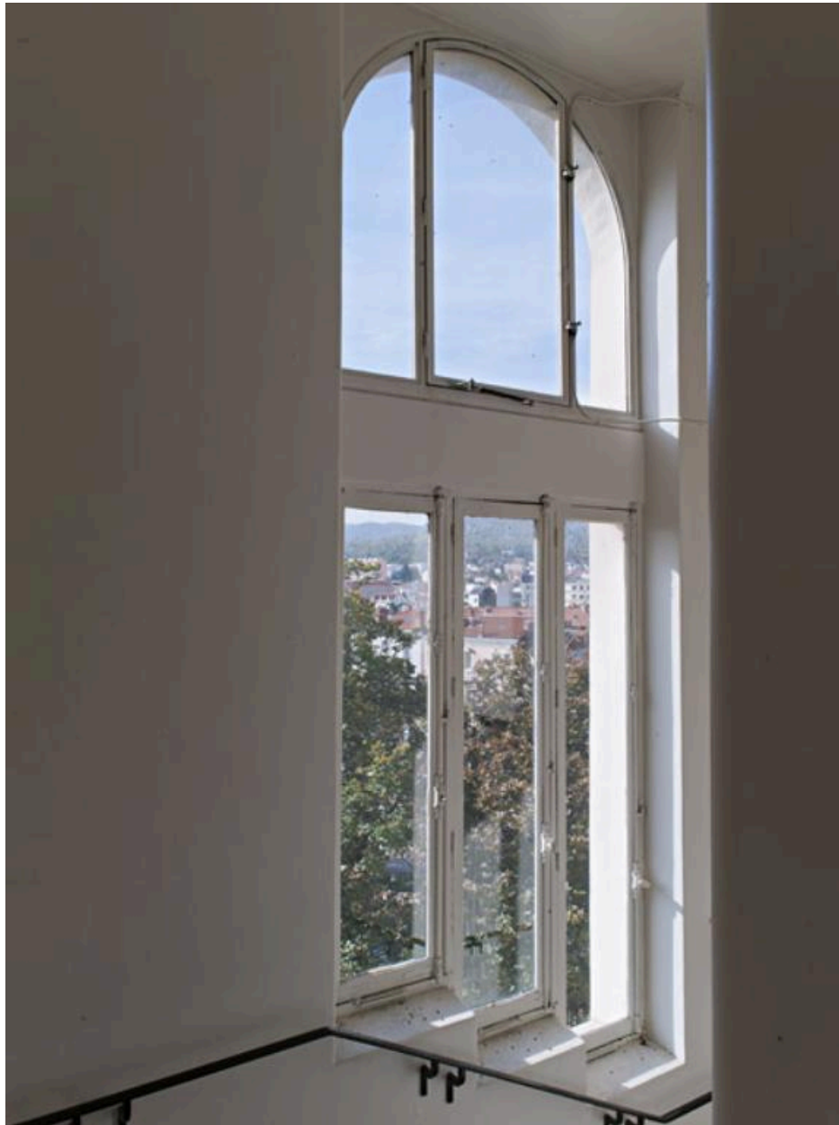
Hôtel-Dieu de Clermont-Ferrand. La polyclinique, baie de la cage d'escalier du pavillon sud (entre les deuxième et troisième étages, photographie prise depuis le nord-est).
