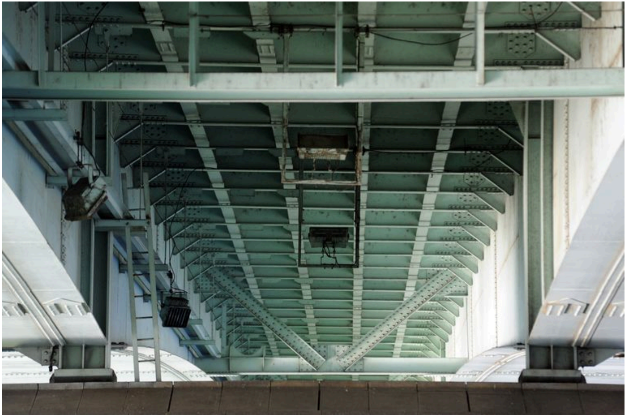
Tablier de la travée gauche, de dessous, vue partielle : structure centrale (depuis la rive gauche)
