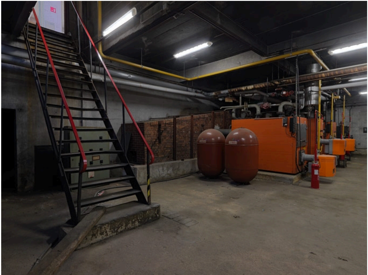
Sous-sol : chaufferie du garage
