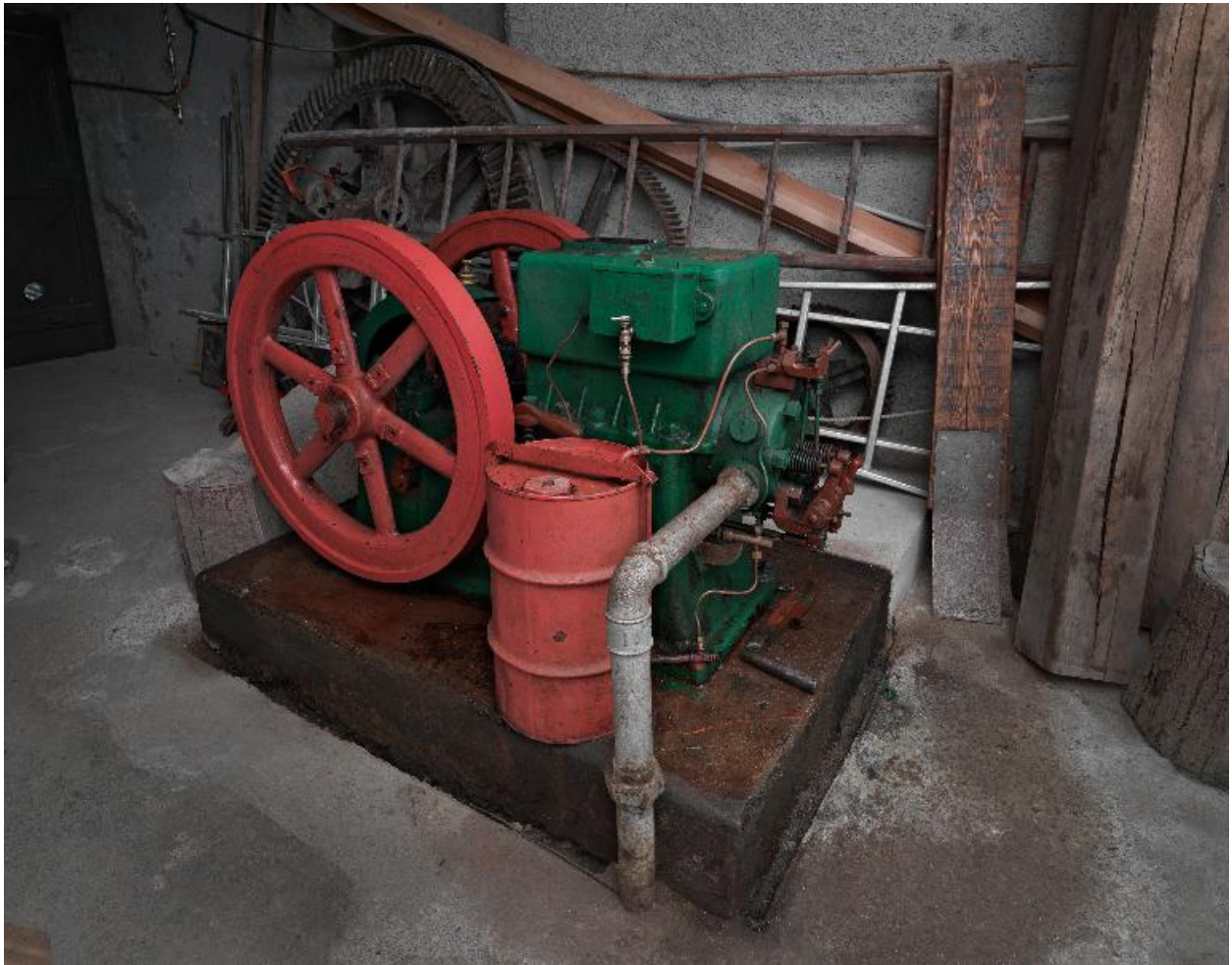
Etage de soubassement : moteur diesel.
