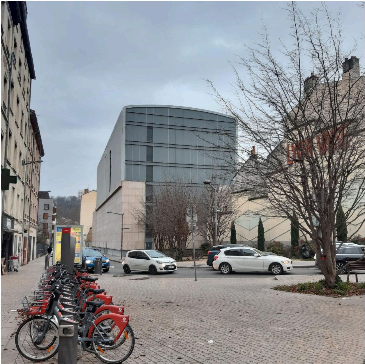
Vue d'ensemble du transformateur EDF Roquette de Vaise
