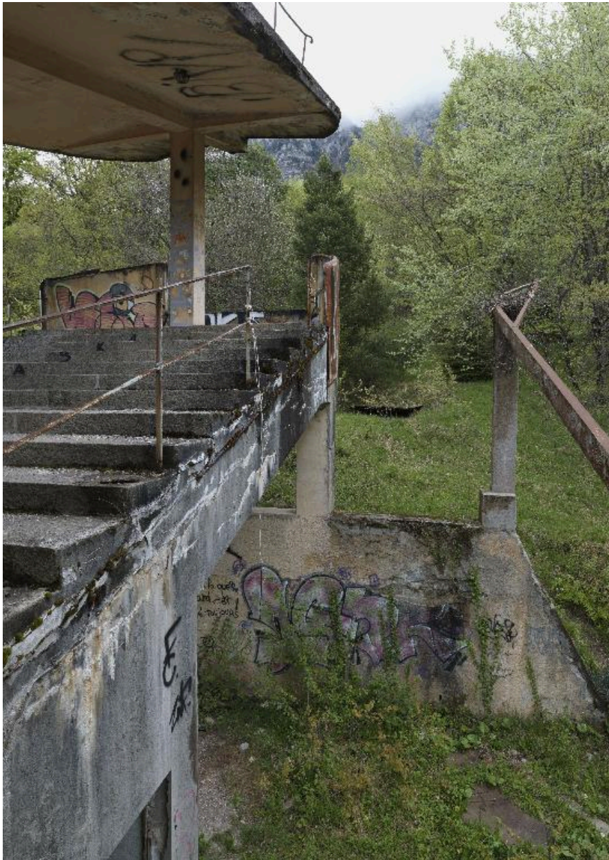
Escalier d'embarquement et rail de guidage des cabines
