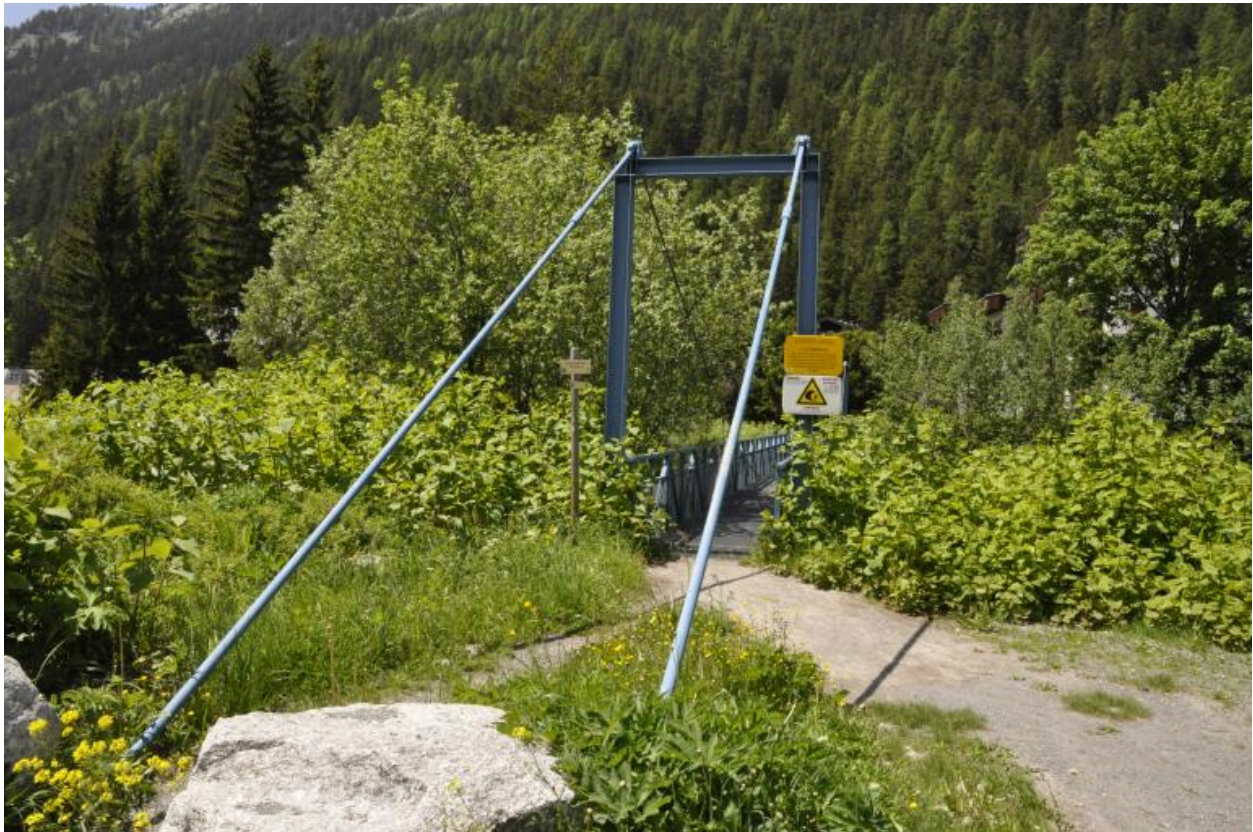
Vue du pylône situé sur la rive gauche stabilisé par des tyrans métalliques
