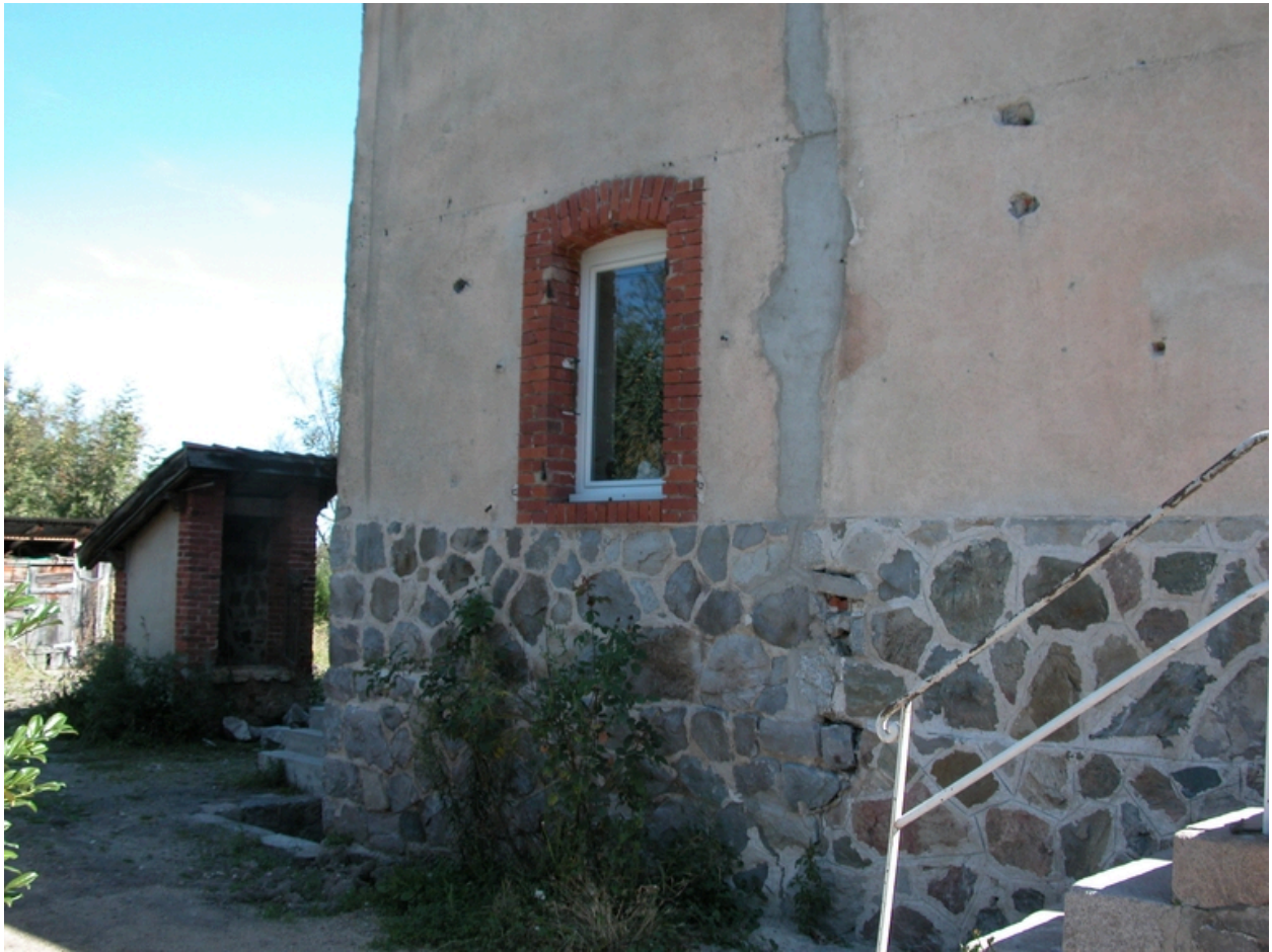
Vue de la maison de garde barrière de Grézieux (le Bourg, 1986 B1 41, 42).
