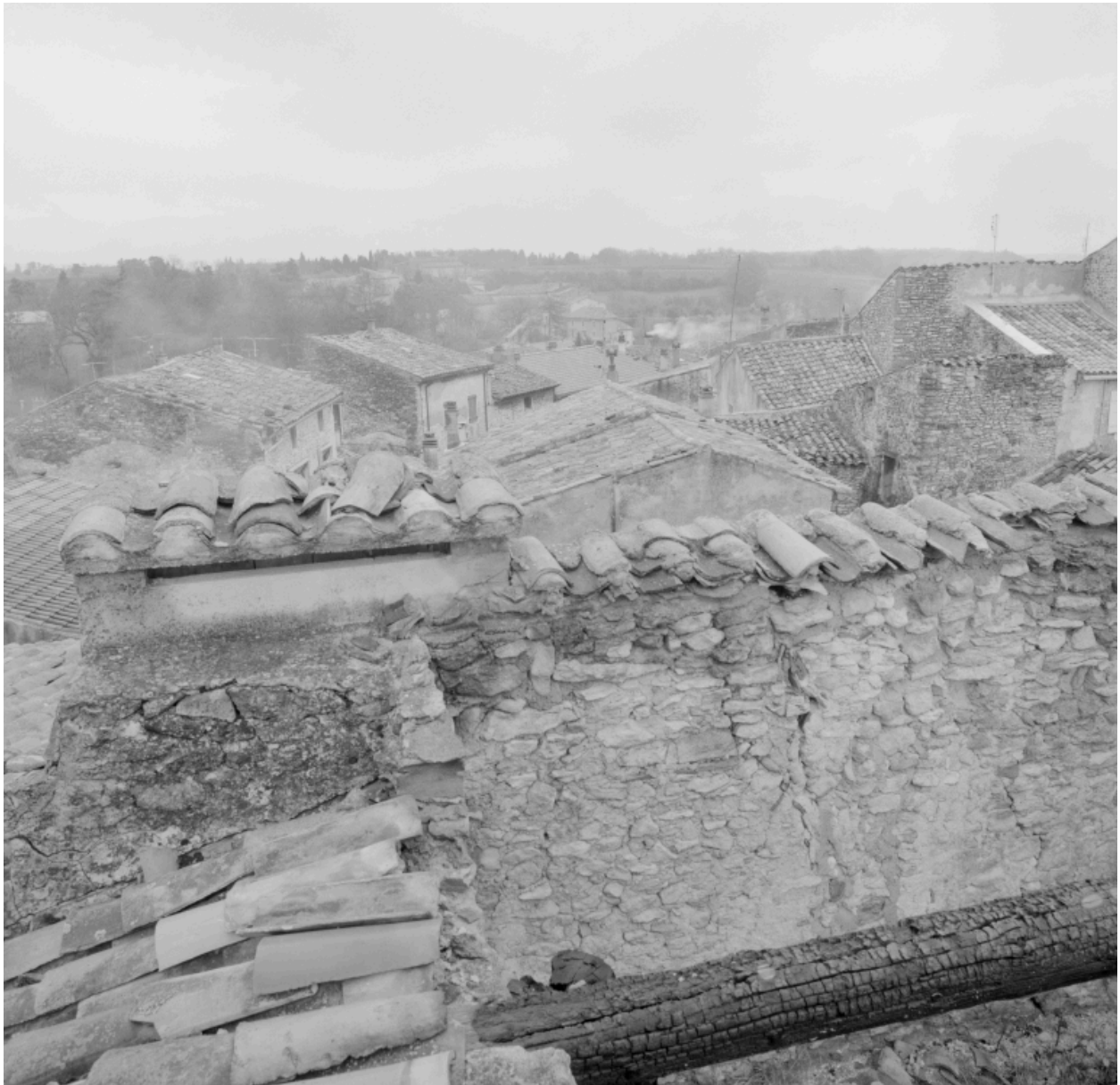
Corps de bâtiment détruit par un incendie, situé au sud-est de la lanterne.
