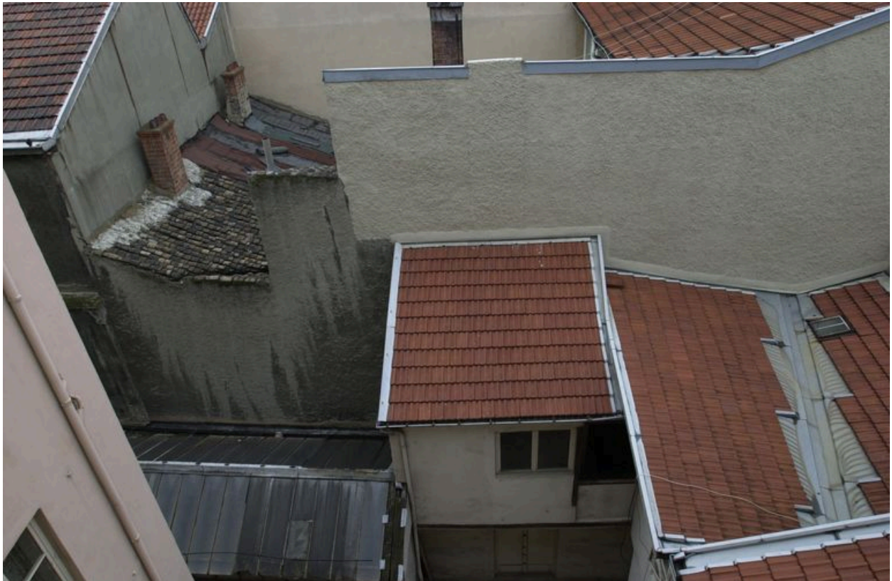
Vue des toits de l'immeuble sur rue et des dépendances au nord de la cour, depuis l'escalier du 2 rue des Trois-Rois
