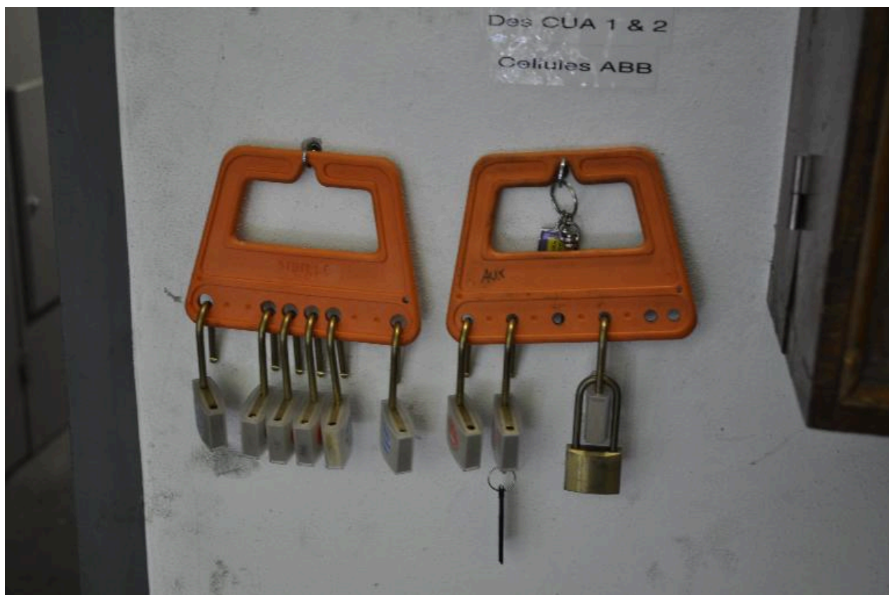
Vue des cadenas de la salle des transformateurs
