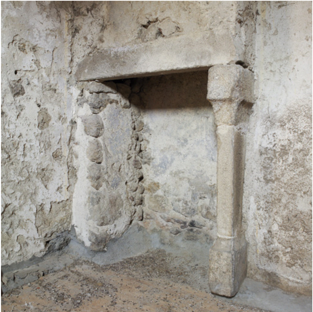
Vue partielle de la cheminée située au premier étage de la tour carrée
