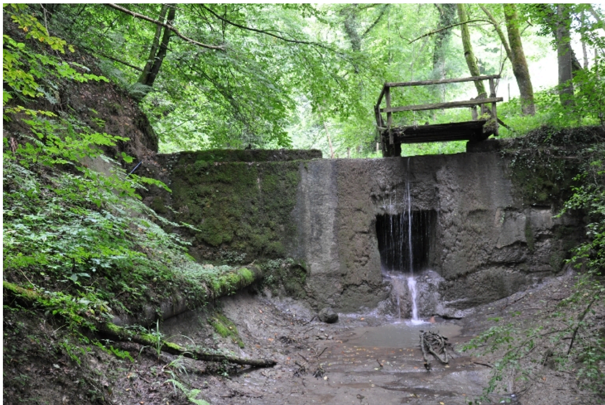
Vue de la prise d'eau sur le ruisseau le Grand-Ruisseau
