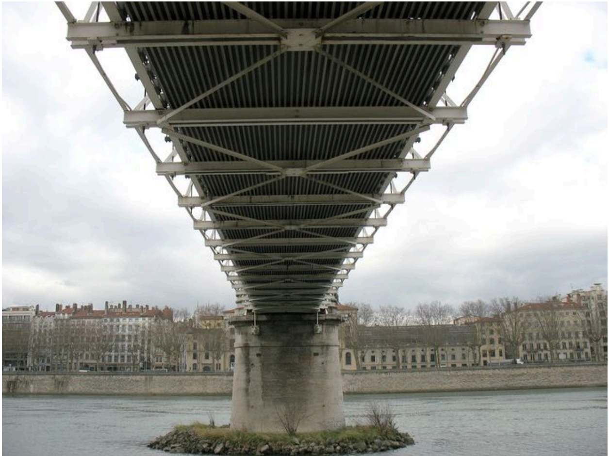
Travée de rive gauche : vue du dessous du tablier et socle inférieur du pylône de gauche (est)
