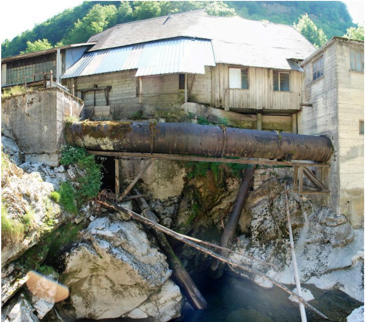
Panoramique de la conduite forcée de la micro-centrale hydroélectrique.
