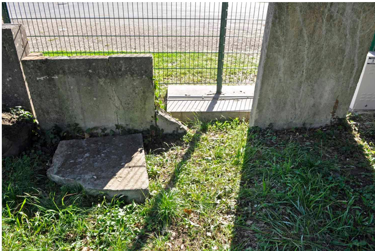
Partie sud : détail d'un panneau cassé
