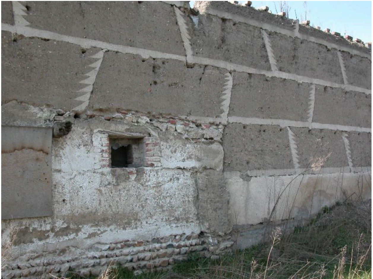
Bourg (le), Mur 1983 B1 719. Détail de mise en œuvre du mur de pisé sur un soubassement constitué de galets.
