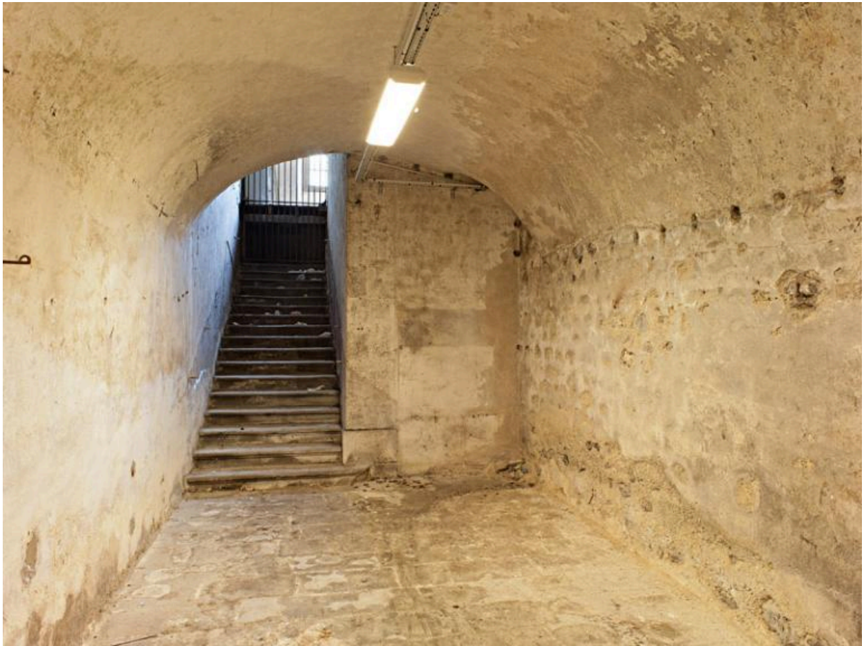
Hôtel-Dieu de Clermont-Ferrand. L'hôtel-Dieu, corps de bâtiment médian, salle au nord-ouest de l'étage de soubassement (accès principal aux galeries souterraines).
