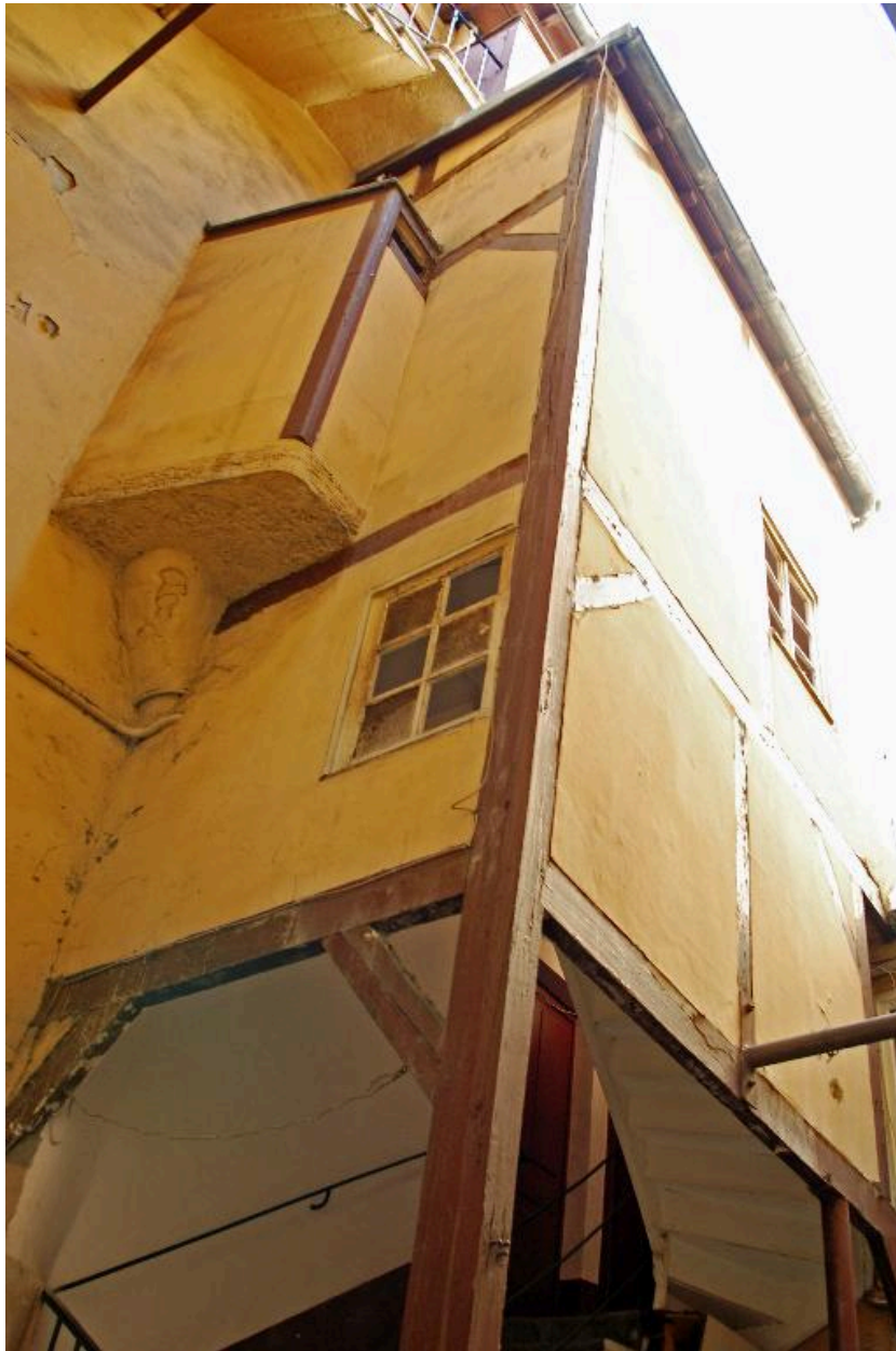
Escalier hors-oeuvre, dans la cour : deuxième volée en charpente et cage en pan de bois
