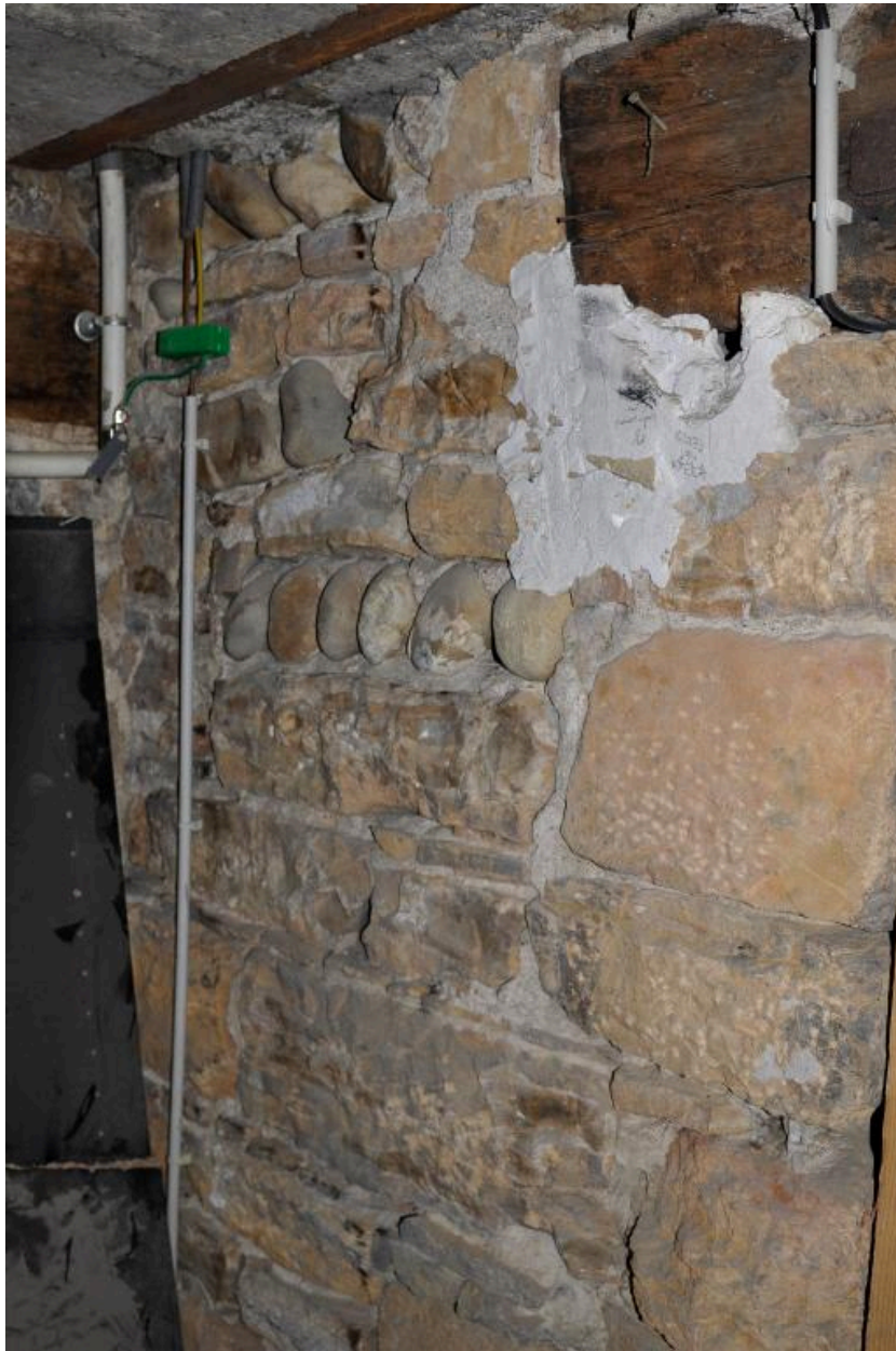
12 grande rue de Vaise : mur du sous-sol en moellon calcaire et galets fluviaux
