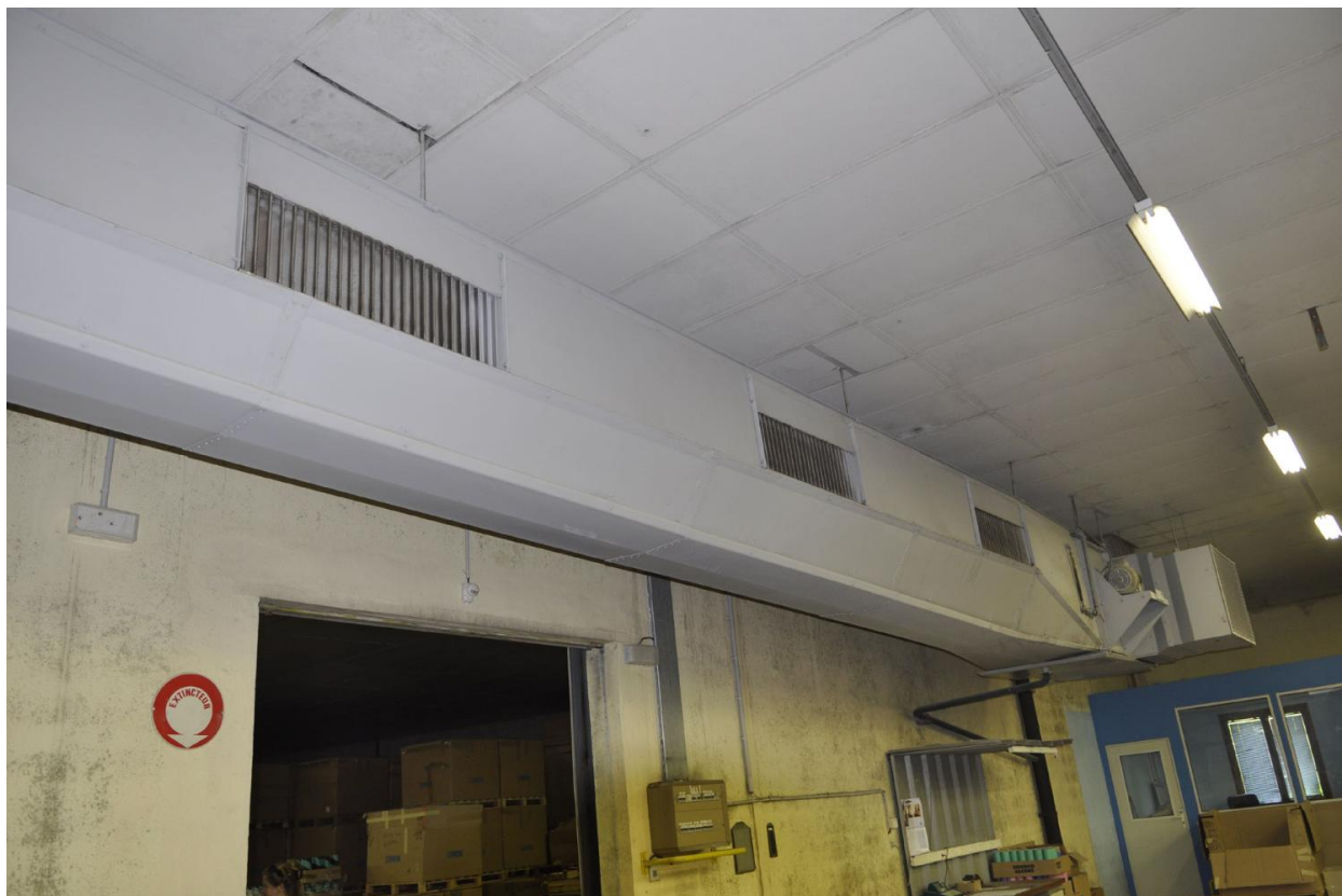
Atelier de texturation détail ventilations (vue d'intérieur)
