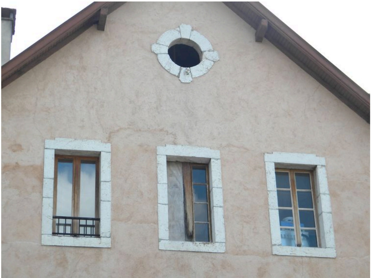
Détail de la façade nord, les fenêtres du premier étage et l'oeil de boeuf.
