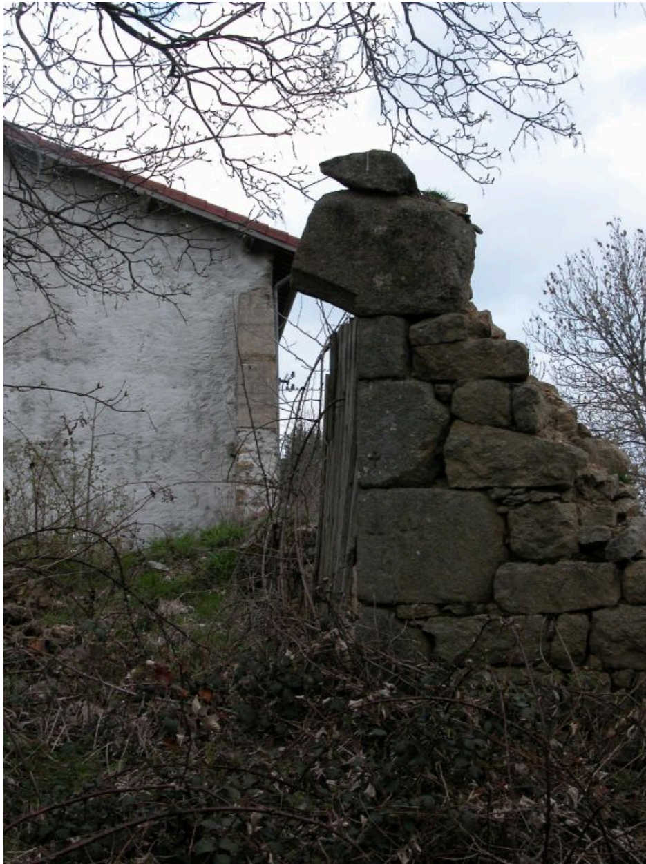
Vue d'un portail ruiné de la grange-étable à l'état de vestiges.
